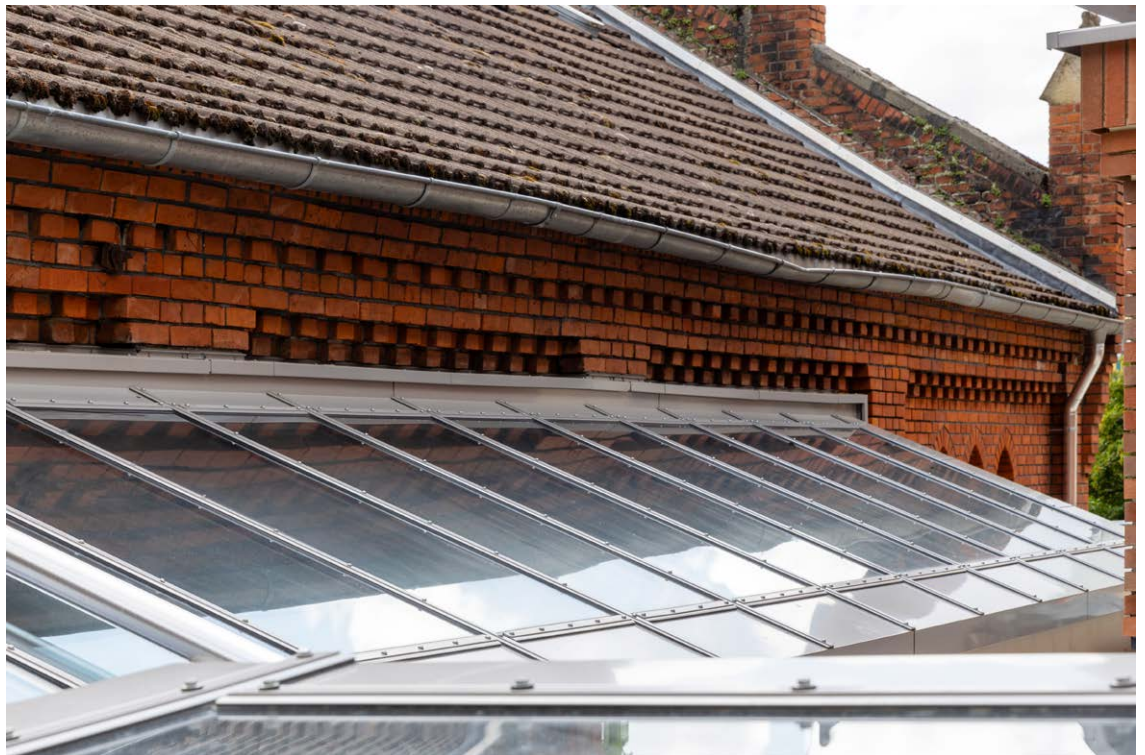
Neues mit Altem kombiniert: Das LAMILUX Brandschutz-Glasdach REI30 angrenzend an den historischen Teil der Goethe Sporthalle in Eisenach.
