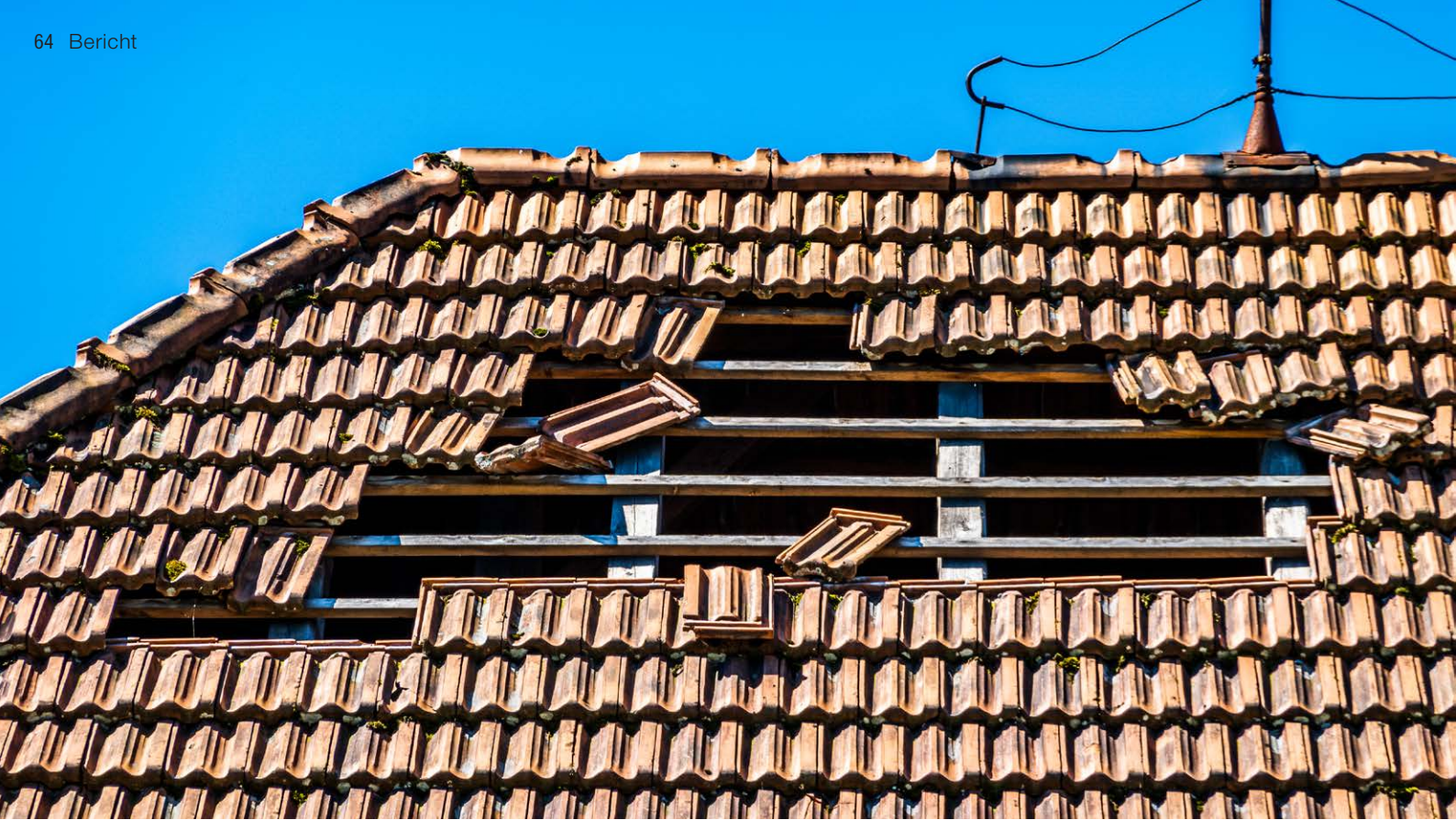
Durch Sturmböhen beschädigtes Dach eines Einfamilienhauses
