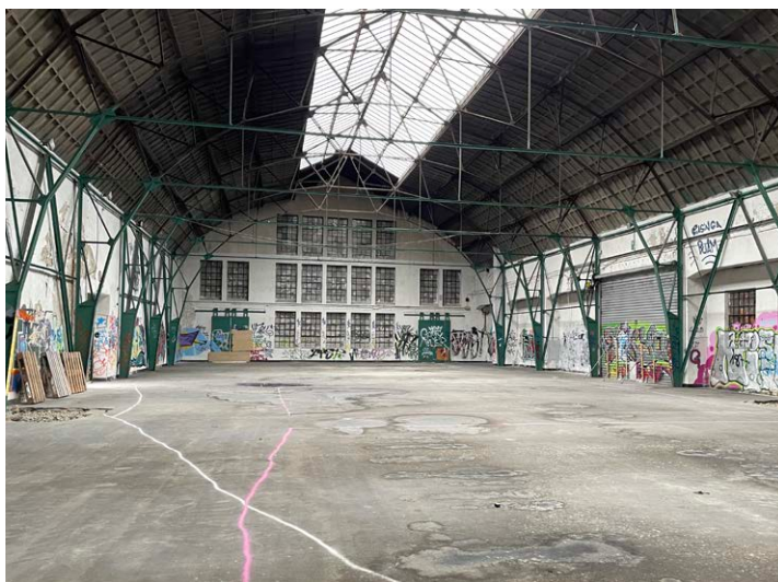
Die Eggenfabrik in München vor der Sanierung: Graffiti zieren die Wände der leerstehenden Halle
