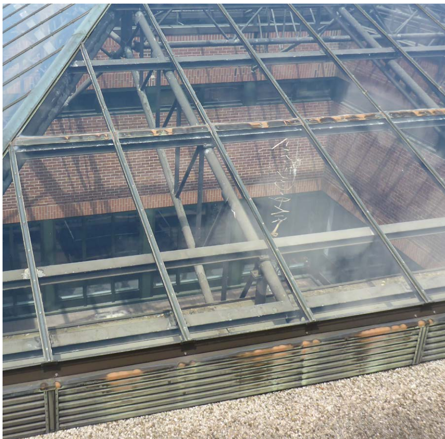
Dante-Gymnasium in München mit altem, unsanierten Glasdach
