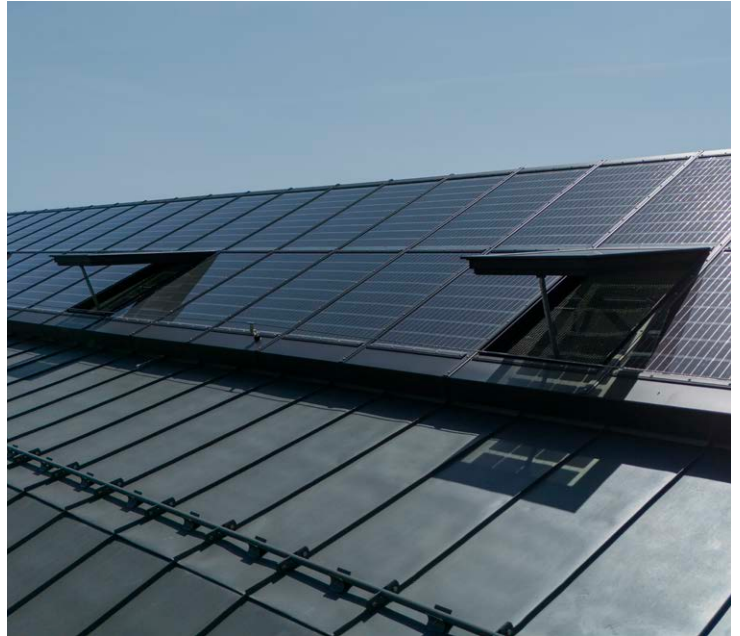
Dach der Zukunft: Im LAMILUX Glasdach PR60 integrierte PV-Anlage auf dem Dach der Eggenhalle in München
