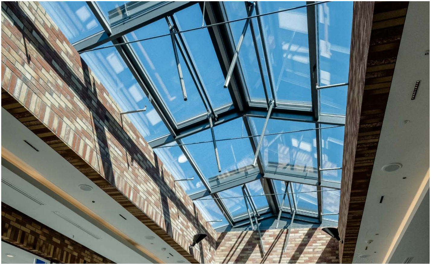
Schultheiss-Quartier – Shopping Center in Berlin mit saniertem LAMILUX Glasdach PR60
